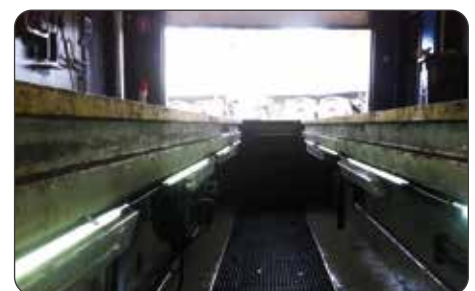
Beispiel für eine LINE LIGHT 6 Lösung am Arbeitsplatz eines LKW-Mechanikers
